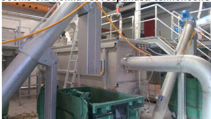
Joonis 6.3 Kohila reoveepuhasti liivapüünis ja võre
