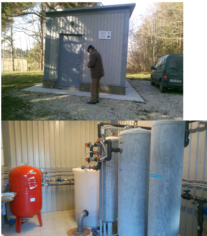
Joonis 5.6 Sutlema puurkaevpumpla ja veetöötlusseadmed
