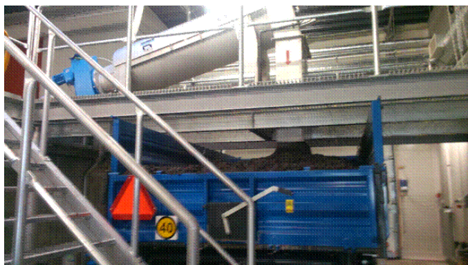
Joonis 6.5 Kohila reoveepuhasti mudatahustusseadmed
